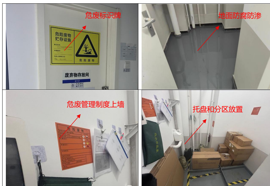
图 3.4-1 本项目危废暂存间设置情况（负二层）
