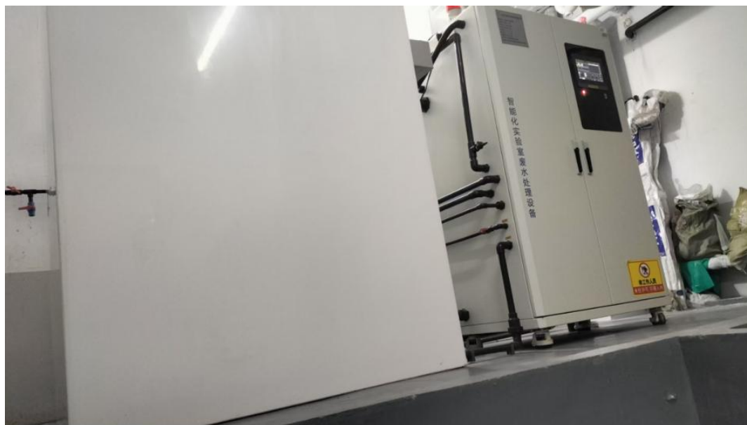
图 3.2-2 废水处理设施（含围堰）照片
